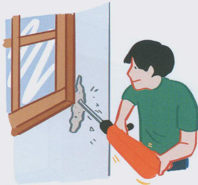
ไม้จริง ติดตั้งระบบเปียก จะรื้อต้องสกัดผนังปูน
